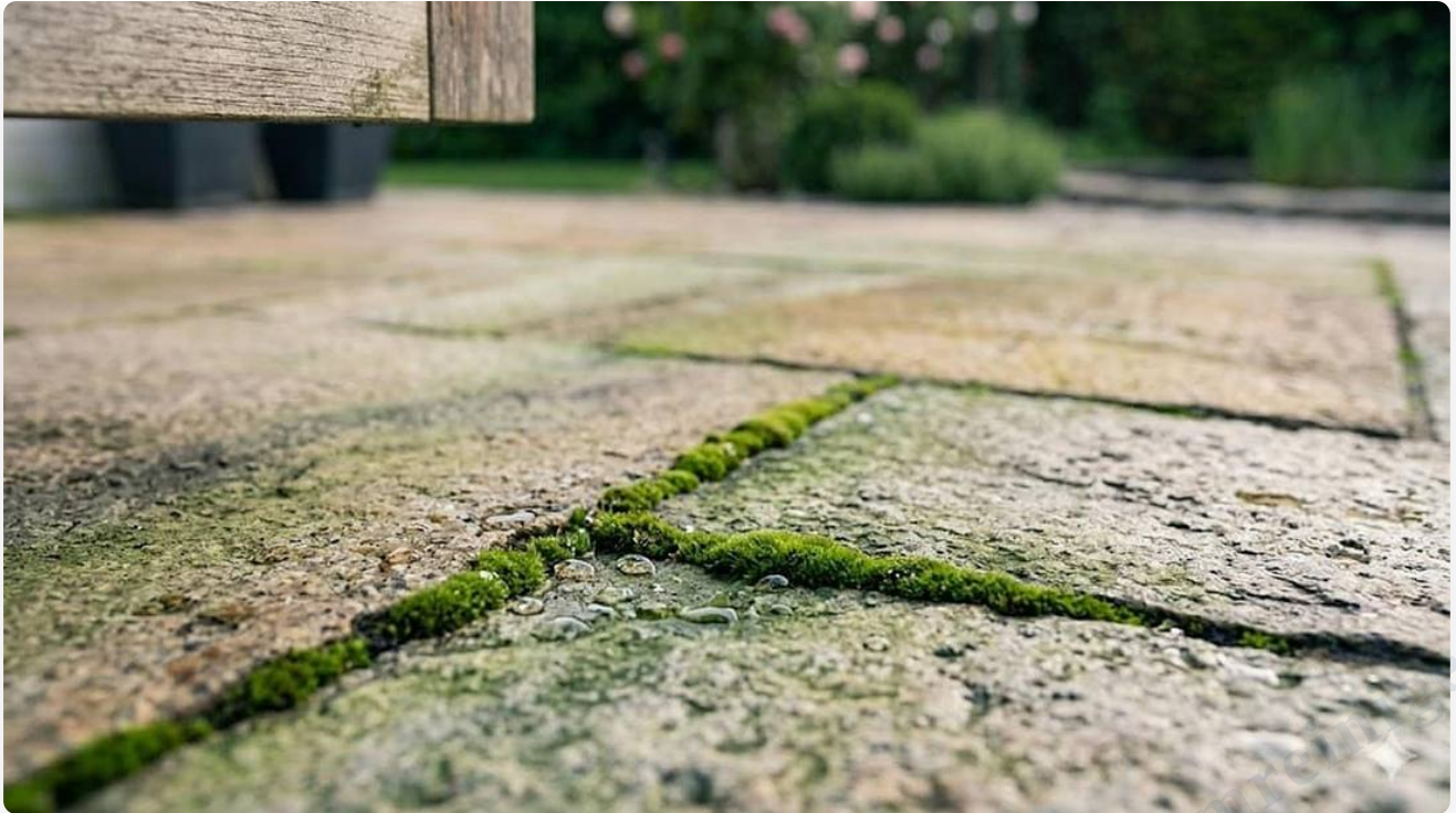
Klassisches Schadensbild: Moos in der Fuge, Algenfilm auf dem Stein — der Bereich, in dem Phoenix arbeitet.
