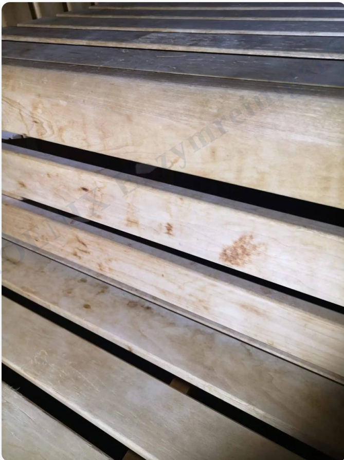
VORHER: Saunabank mit eingedrungenen Schweißflecken und Stockflecken
